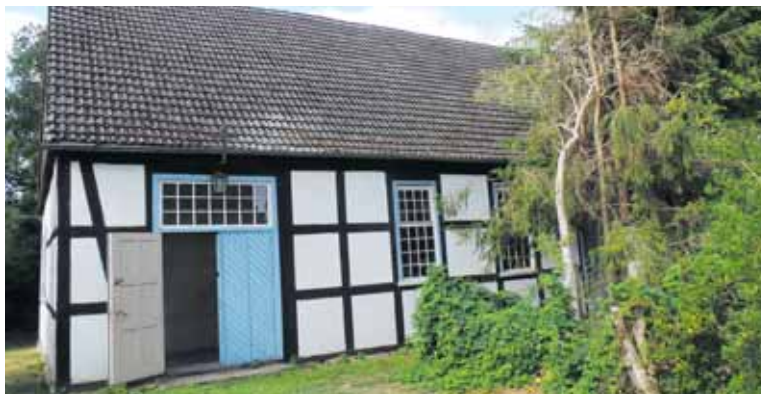
Die Scheune beherbergt eine Kirche. Doch die ist in die Jahre gekommen und nun ist eine 12 000 Euro teure Dachsanierung notwendig. Foto: Förderverein Scheunenkirche Wilmersdorf e. V. (FSW e.V.), Dietrich von Buch, CC-BY-NC-SA
